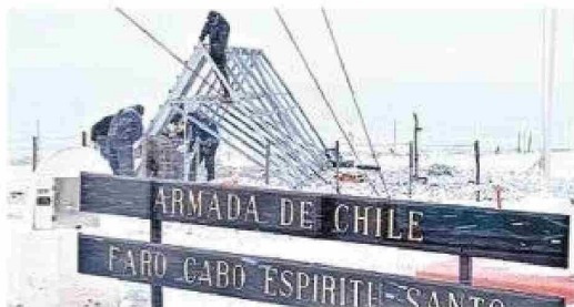
Militares argentinos en plena faena de desmonte de los paneles solares que habían sido instalados en territorio chileno.
