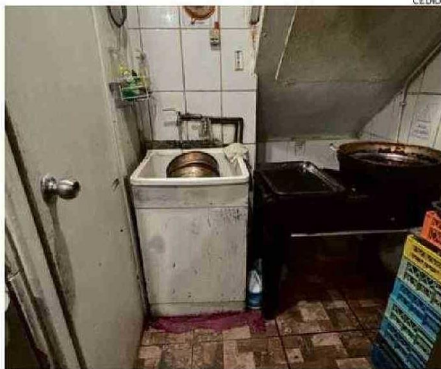
EL LUGAR NO POSEE CONDICIONES HIGIÉNICAS NI ESTRUCTURALES.
