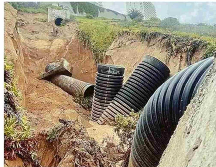
A MEDIADOS DE AGOSTO EL COLECTOR DIO PASO A UN SOCAVÓN.
