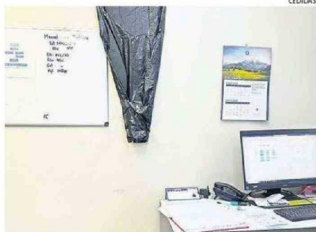
CON BOLSAS TIENEN QUE EVITAR LAS GOTERAS CUANDO LLUEVE.
