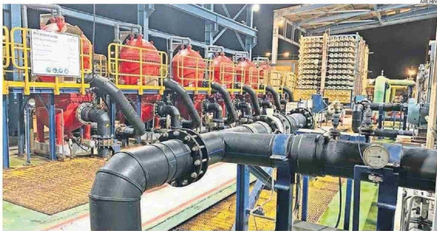
LA DESALADORA DE ADASA PRODUCE CASI 1.000 L/S. LA PLANTA DE ESCONDIDA(BHP) PODRÍA APOYAR CON UN SUMINISTRO ALTERNATIVO A LA CIUDAD.
