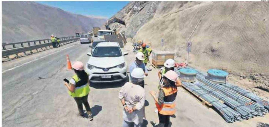
LOS REITERADOS DERRUMBES DEBIDO A LAS OBRAS QUE SE REALIZAN EN LA ZONA, HAN GENERADO DIVERSOS CORTES DE RUTA.
