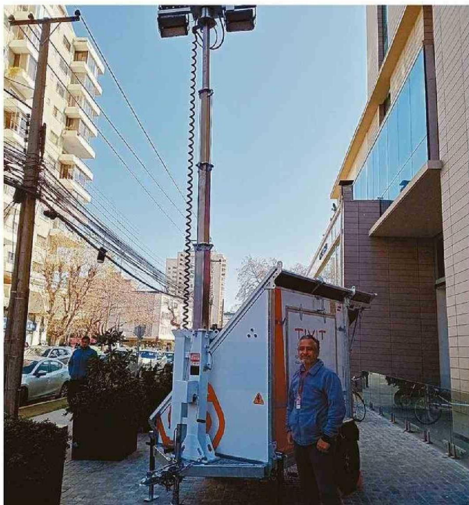
BENJAMÍN HERNÁNDEZ: "ESTÁ LIBRE DE EMISIONES CO2. ACCESO A INTERNET EN PARQUES SOLARES, EÓLICOS Y MINAS A CIELO ABIERTO. OFRECE TODO TIPO DE SOLUCIONES. IDEAL PARA EMERGENCIAS".
