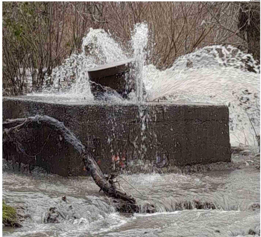
ESTE SÁBADO 10 DE AGOSTO SE VOLVIÓ A REPETIR LA MISMA FUGA DE AGUAS SERVIDAS, PERO A DIFERENCIA DEL 1 DE AGOSTO, SIN LLUVIAS.
