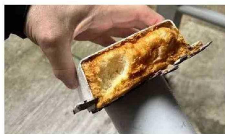
LA ESPONJA DENTRO DE LOS DUCTOS DE VENTILACIÓN DE LAS LOGIAS.
