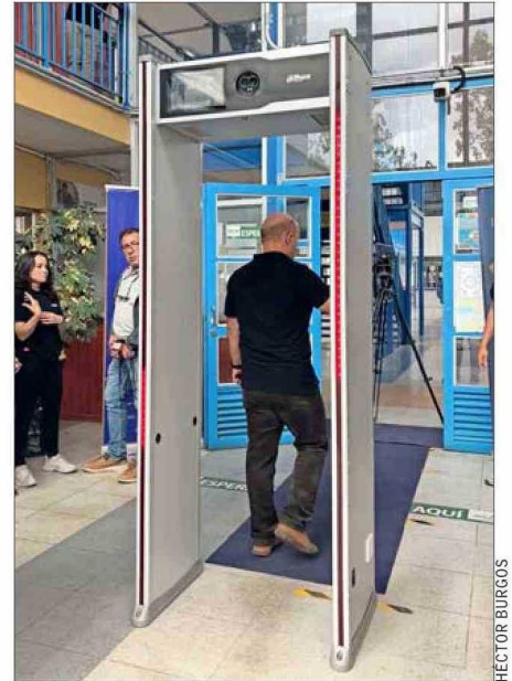
El pórtico también cuenta con una cámara térmica para hacer conteo de personas.
