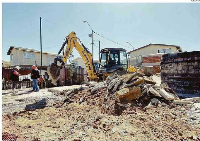
EL VIERNES COMENZÓ EL TRABAJO DE DEMOLICIÓN POR PARTE DE LA CONSTRUCTORA EN EL SECTOR.
