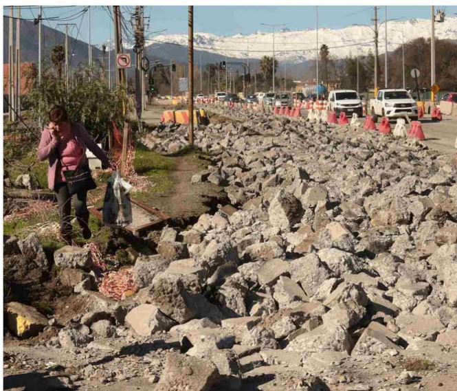
Inconclusas están las obras en la vía, especialmente en el tramo que va desde la avenida Bombero Villalobos hacia el oriente.
