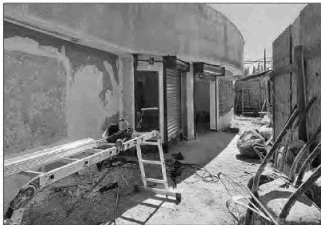
Ya se está trabajando en la construcción de la nueva Farmacia Comunal de Quillota.
