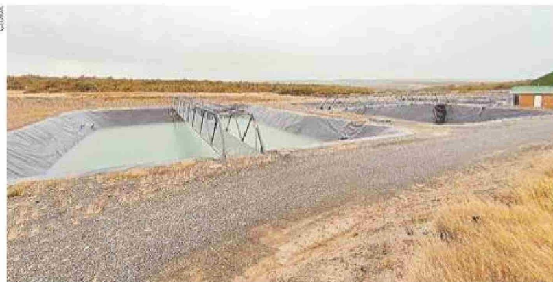
A más de tres años de terminadas las obras, aún no se puede utilizar el relleno sanitario.
