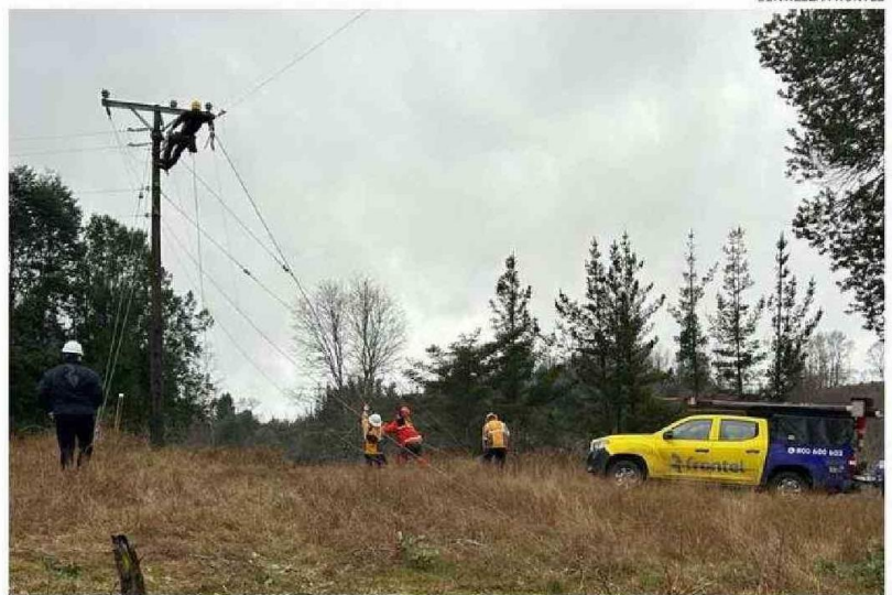
FRONTEL RECONOCIÓ QUE DEBIDO A LA MAGNITUD DEL DAÑO HAN TENIDO QUE RECONSTRUIR LÍNEAS ENTERAS.
