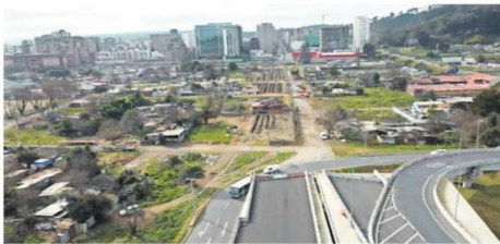
Los trabajos para la conexión del puente Bicentenario y Chacabuco consideran una inversión de $30 mil millones. Estarán listos en 2025.
