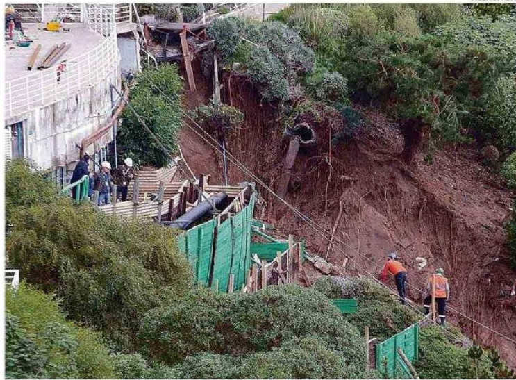
DURANTE EL PRIMER SISTEMA FRONTAL DE JUNIO SE PRODUJO ESTE TERCER SOCAVÓN EN COCHOA.
