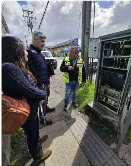
REVISIÓN DE CONTROLADOR DE SEMÁFORO EN QUELLÓN.
