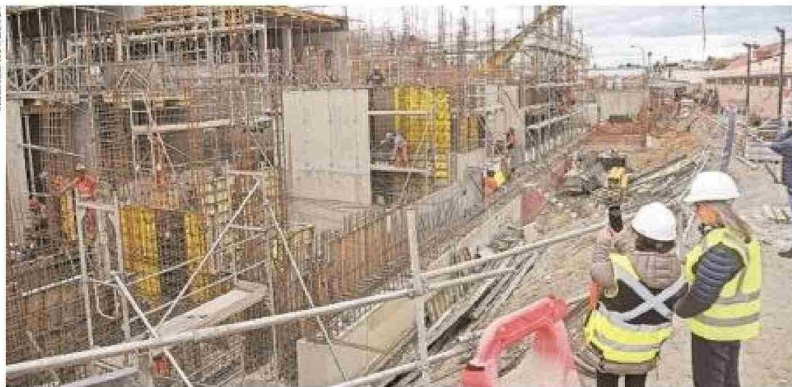
La estructura del nuevo Cesfam ya comienza a tomar forma y se puede apreciar cuánto se ampliarán los espacios de atención al público.
