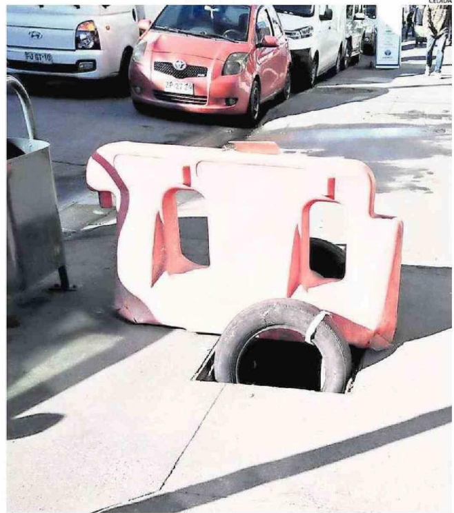
ASÍ SE ENCUENTRA ESTA CÁMARA EN CALLE SALAS. EL COSTO PARA REPONERLAS ES MILLONARIO.
