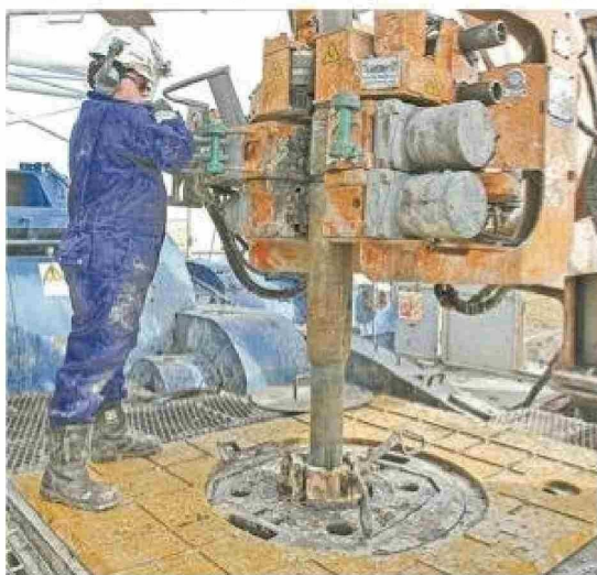
Equipo de perforación de Enap Magallanes.
