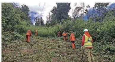
Junto a la comunidad y con todos los recursos en terreno la compañía avanza para asegurar el mantenimiento de su red eléctrica
