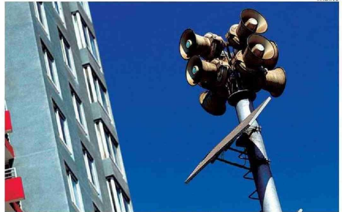
ESTE NUEVO SISTEMA CONTEMPLA POSTES DE ACERO DE 11 METROS DE ALTURA.
