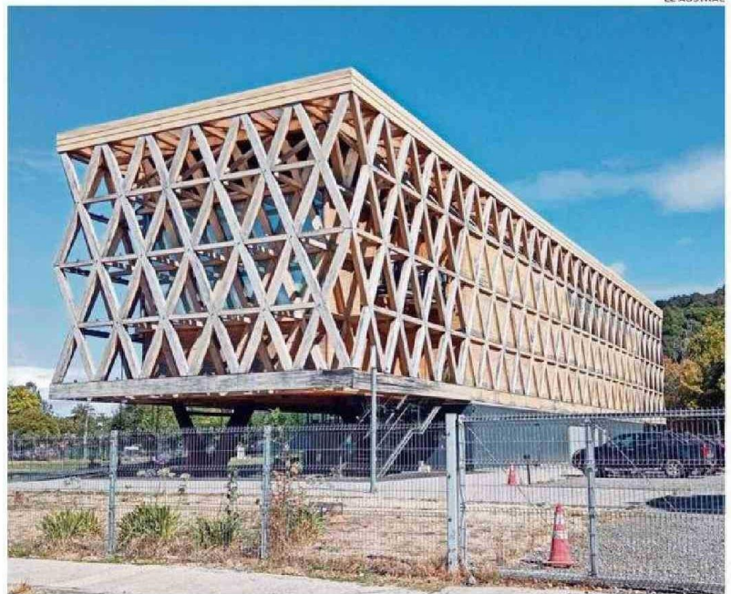
EL PABELLÓN ARAUCANÍA YA MUESTRA DETERIORO EN BUENA PARTE DE LOS MADEROS QUE LO CONFORMAN.
