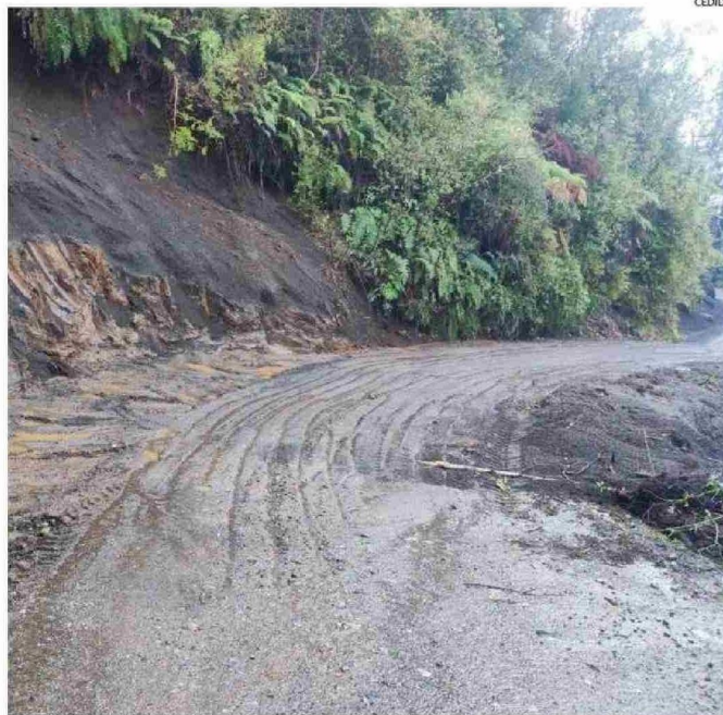
LOS CAMINOS EN MAL ESTADO ES UN PROBLEMA TRANSVERSAL EN LA REGIÓN, TAL COMO EN RUPANCO.
