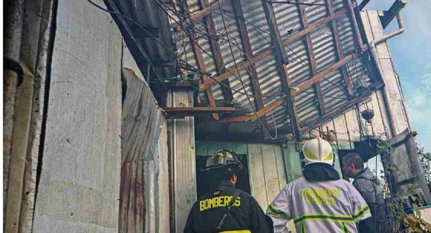
Producto de los tornados se volaron techumbres, lo que provocó que el agua de las lluvias ingresara a las viviendas.
