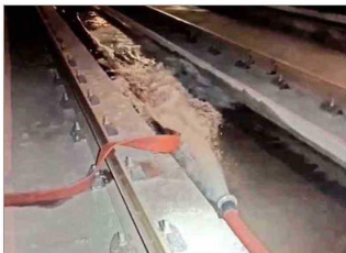
Adecuaciones. La empresa está considerando instalar de forma permanente bombas con mayor capacidad en puntos de la red.
