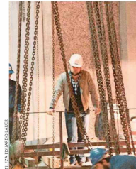
Lauer se define como “faenero”, un ingeniero de terreno. “Para mí, no hay nada mejor que construir, ver que algo está saliendo de la tierra y después funciona. Eso es increíble”.
