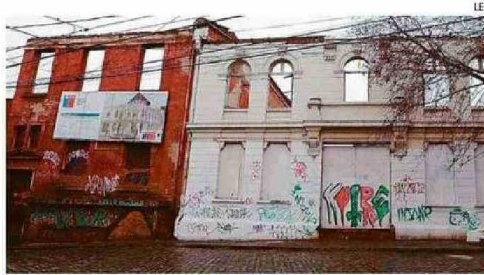
LA UV TRABAJÓ PARA RESTAURAR SINIESTRADO INMUEBLE.
