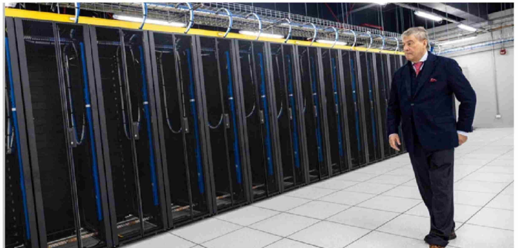
El presidente de GTD, Manuel Casanueva, en el data center inaugurado este jueves en el barrio Lurín, de Lima, en Perú.
