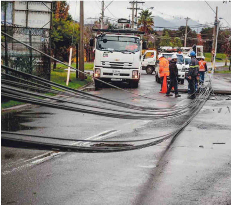
Afectados. Cerca de siete millones de chilenos fueron afectados por los cortes eléctricos de agosto del año pasado. / AGENCIA UNO
