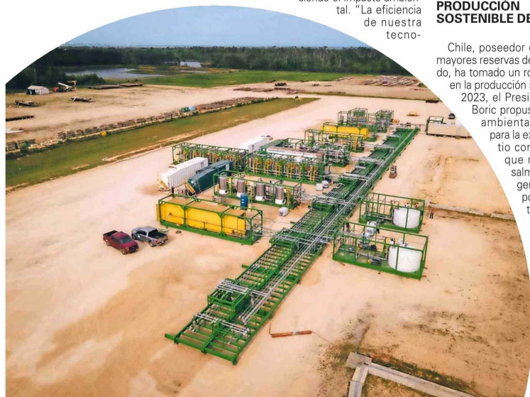
Planta de Extracción Directa de Litio (DLE) de Sorcia.
