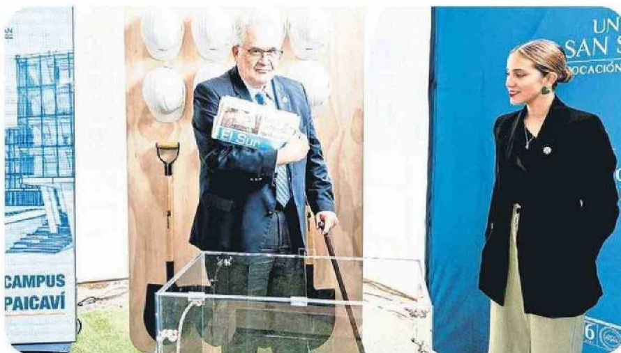
El rector de la USS, Hugo Lavados, depositó un ejemplar de Diario El Sur en la caja que quedará en los cimientos del nuevo edificio.
