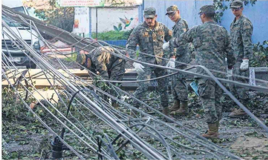
Personal del Ejército se unió ayer a los trabajos de los municipios y las empresas para restablecer la energía eléctrica.
