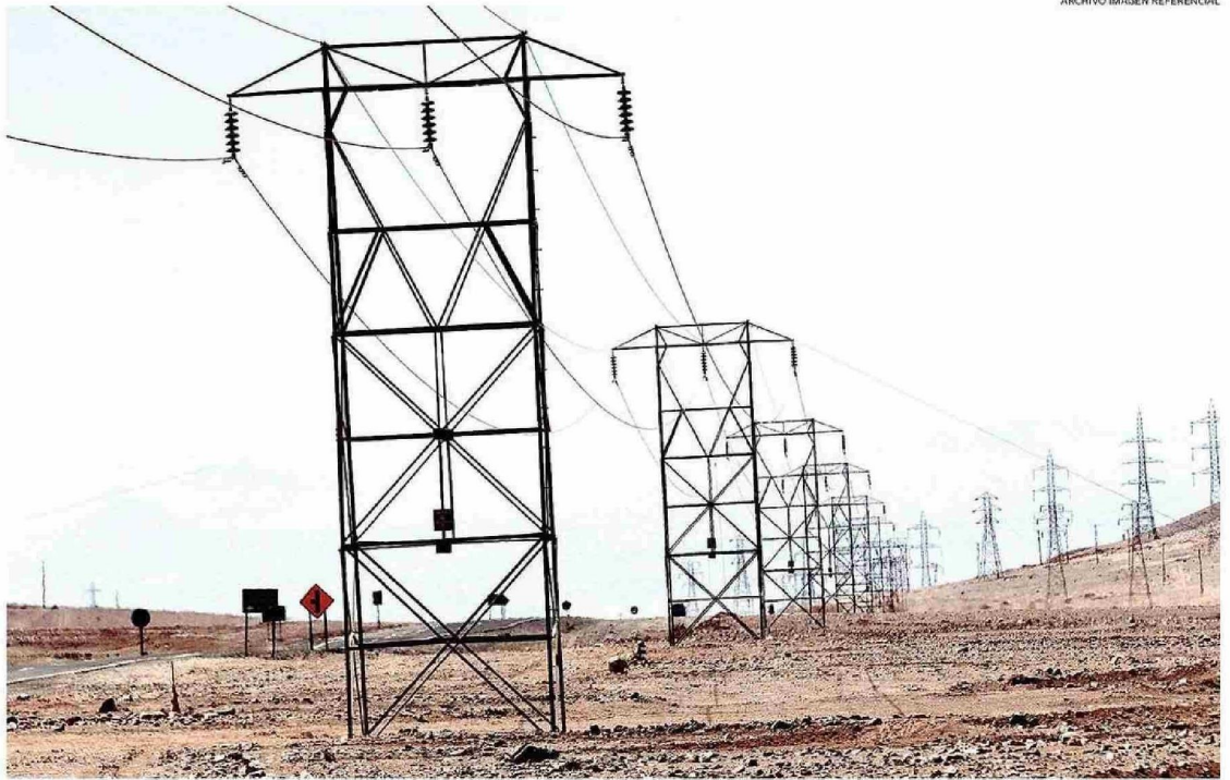
NUEVAS TORRES DE ALTA TENSIÓN SE DESPLOMARON EN MAYO DE ESTE AÑO TRAS EL ROBO DE PERFILES QUE DAN SOPORTE A LAS ESTRUCTURAS.
