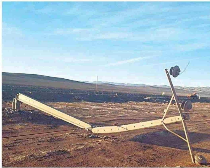
ESTE NUEVO EPISODIO DE ROBO DE CABLE DEJÓ SIN SUMINISTRO ELÉCTRICO A LA LOCALIDAD DE BAQUEDANO.
