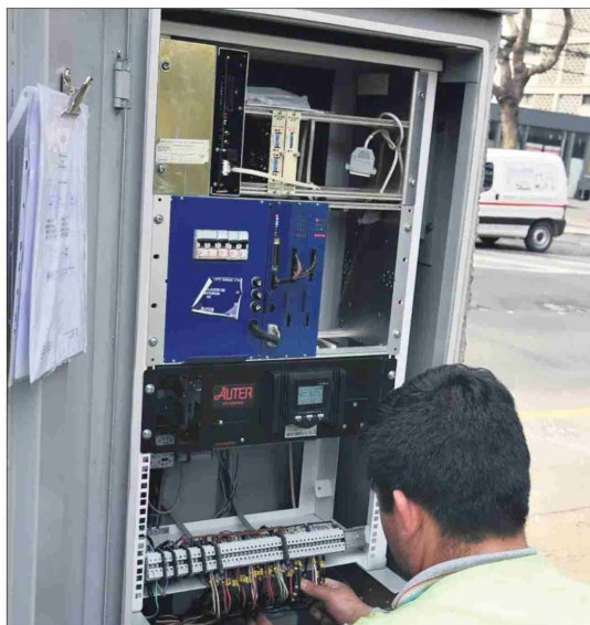
La caja negra de esta unidad de control es el respaldo energético que se está instalando.
