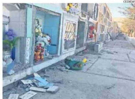
AL MENOS SON 60 NICHOS SUFRIERON DAÑOS Y ROBOS EN CHUQUIL.
