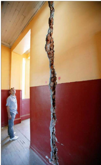
Tras el sismo de 2010, muchos edificios fueron demolidos porque sus daños estructurales eran irreparables.
