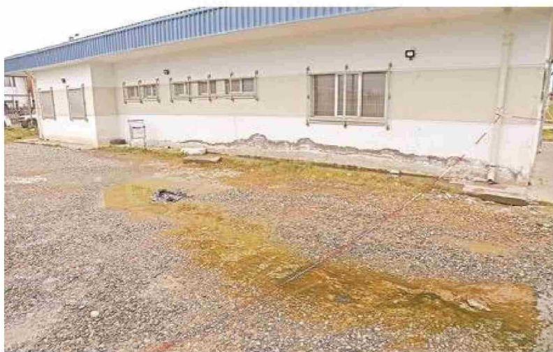
La presencia de aguas servidas invade este consultorio de salud que permanece cerrado por mandato sanitario.
