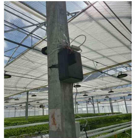
Sistema de toma de datos instalados en predios de productores.
