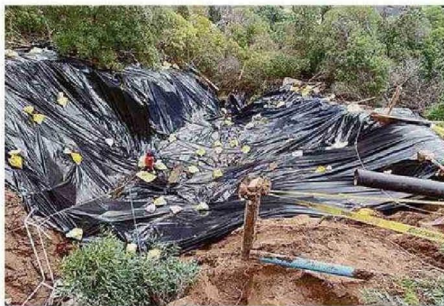
LA LÁMINA CUBRE UN 70% DE LA SUPERFICIE DEL SOCAVÓN.
