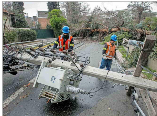
LO BARNECHEA. —Producto del viento, un eucalipto cayó en la calle Camino Turístico, en el sector oriente de la Región Metropolitana. Cortó el tránsito y dejó sin electricidad el sector.
