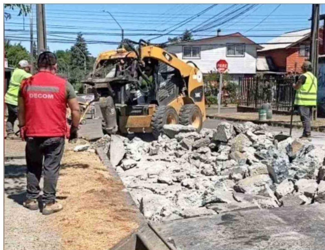
Zona residencial. En la pequeña calle Mónaco, situada en el sector Regional, también fue necesario efectuar reparaciones.
