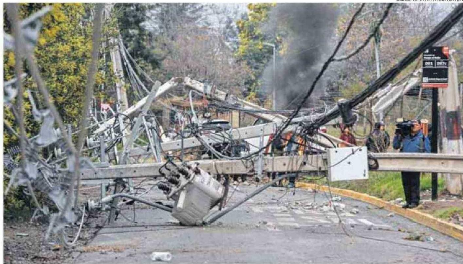
CUATRO POSTES CAYERON EN UN SECTOR DE PEÑALOLÉN, REGIÓN METROPOLITANA, LO QUE DEJÓ A LOS VECINOS SIN ENERGÍA ELÉCTRICA.
