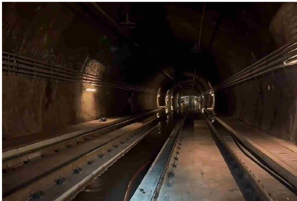
► Acumulación de agua en el túnel del Metro, a la altura de la estación Bío Bío, en la línea 6.
