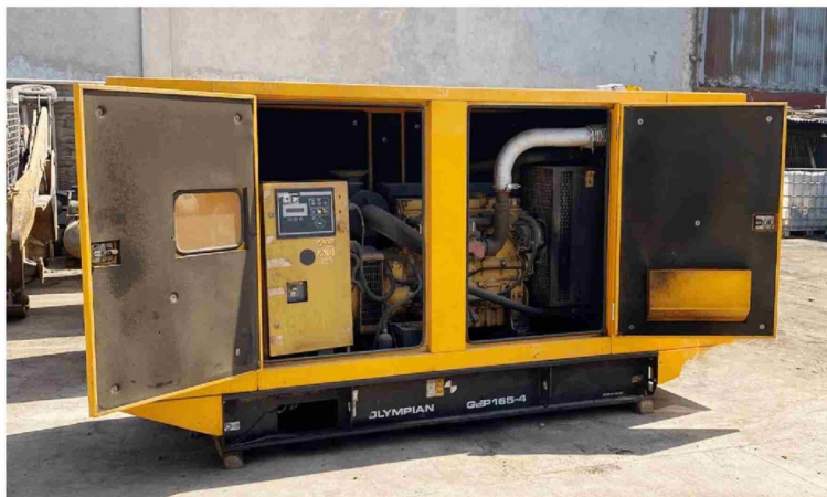
EL GENERADOR QUE APORTA la electricidad en el hospital cuando falla el servicio regular.
