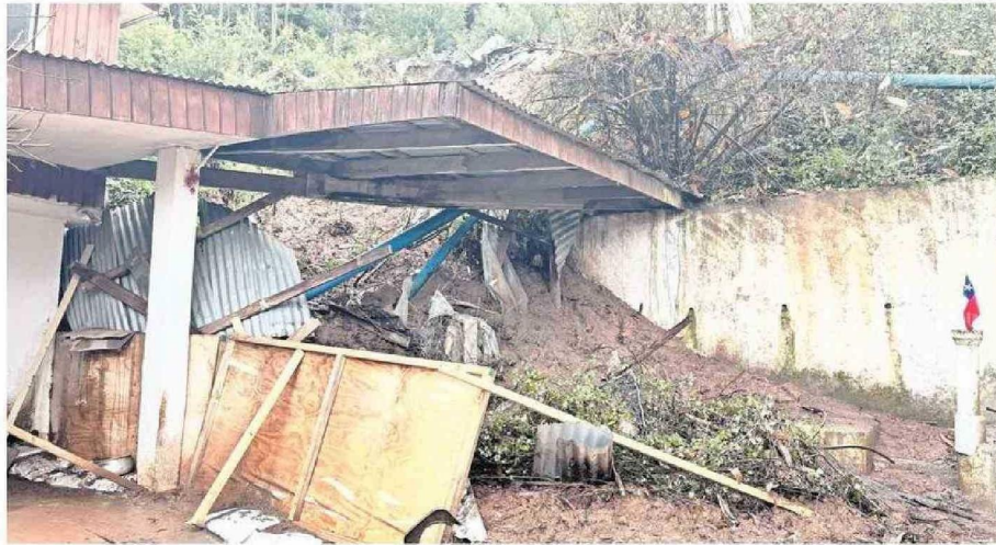
DIVERSAS VIVIENDAS UBICADAS EN CERROS SE VIERON AFECTADAS POR DESLIZAMIENTO DE TIERRAS POR EL SISTEMA FRONTAL.
