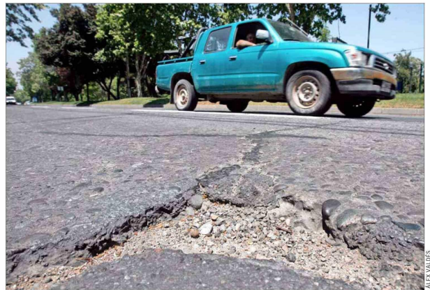
DETERIORO. — En la Municipalidad de Las Condes concuerdan con la vecina sobre el deterioro de este camino público (administrado por el MOP), especialmente en el tramo entre Kennedy y Bilbao.
