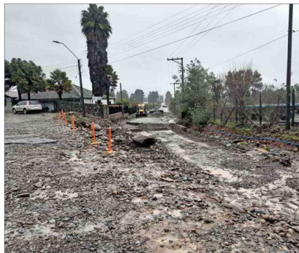
SAN CLEMENTE.— Lluvias que superaron los 100 milímetros en un día colaboraron a generar un nuevo corte en la ruta K-679, en Maule.
